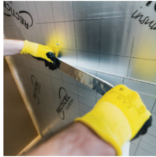
14. Teippaa kaikki liitoskohdat alumiiniteipillä. Teippaa myös läpivientien ja lauteiden saumaukset sekä kiinnikkeiden kannat.
